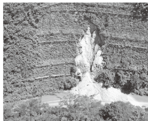
豪雨による災害(広域農道)
