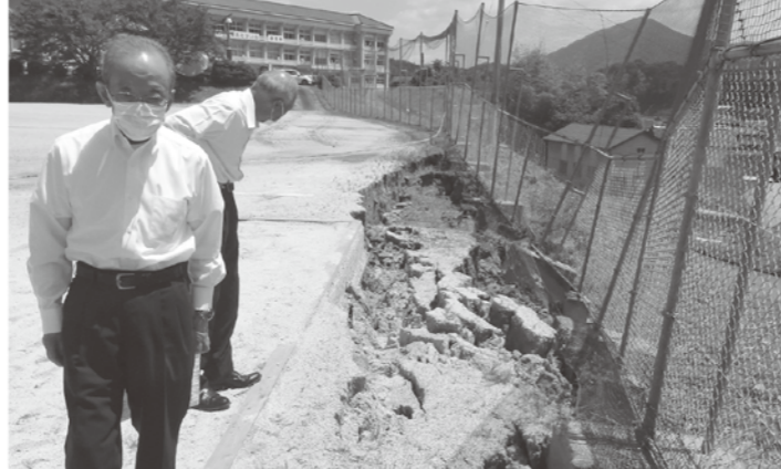
赤来中学校グランド法面崩落現場視察
