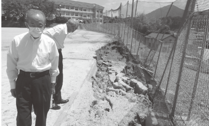
赤来中学校グラウンド法面崩落現場視察
