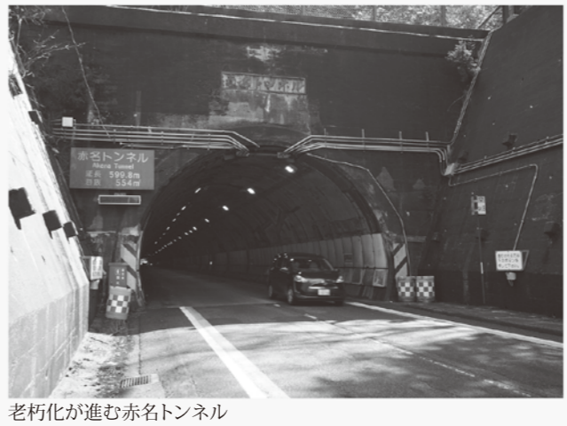
老朽化が進む赤名トンネル
