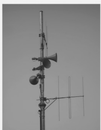
役場庁舎に隣接するアンテナとスピーカー
