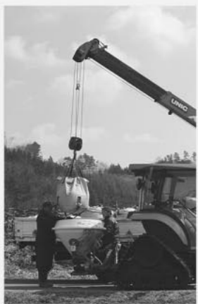
土改剤散布作業
