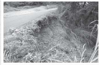
崩壊した道路
