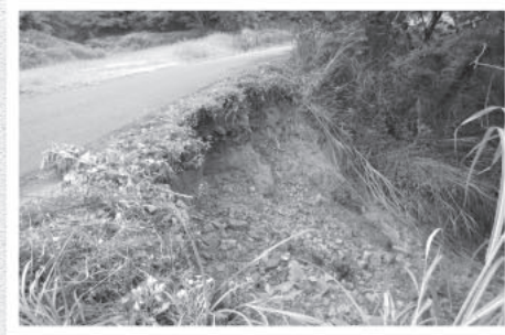
崩壊した道路
