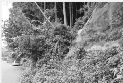
崩れかけた町道法面
