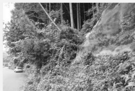
崩れかけた町道法面
