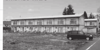
老朽化が進む町営住宅
