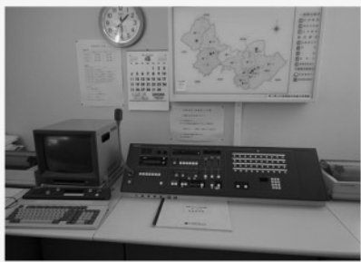
防災行政無線施設
