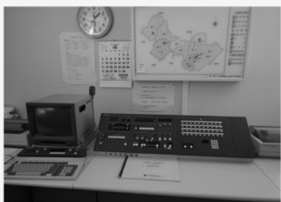
防災行政無線施設
