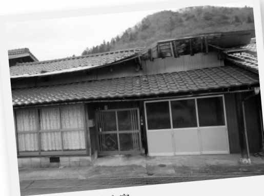
倒壊が始まった空家
