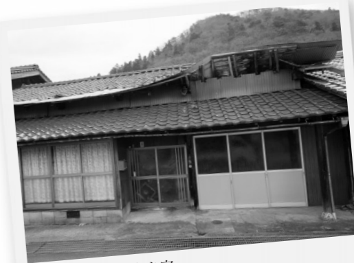
倒壊が始まった空家
