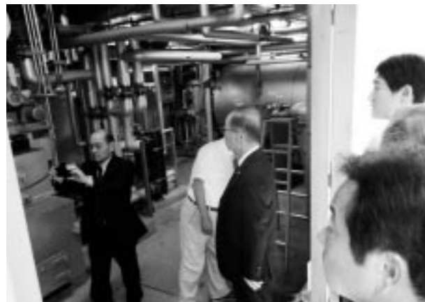
メタンガス処理施設
