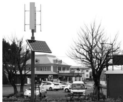
急速充電施設
