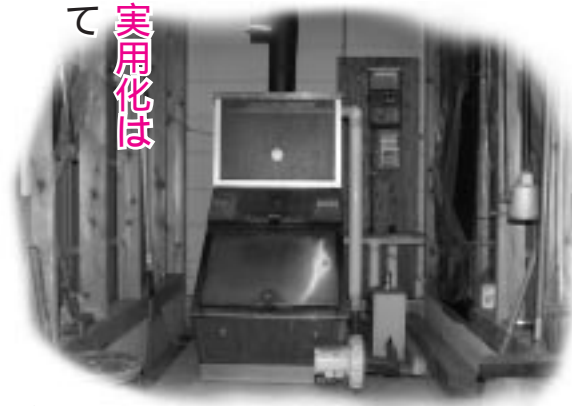
まきボイラー
