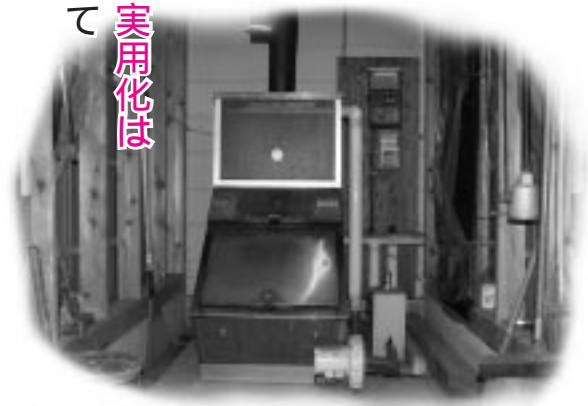
まきボイラー
