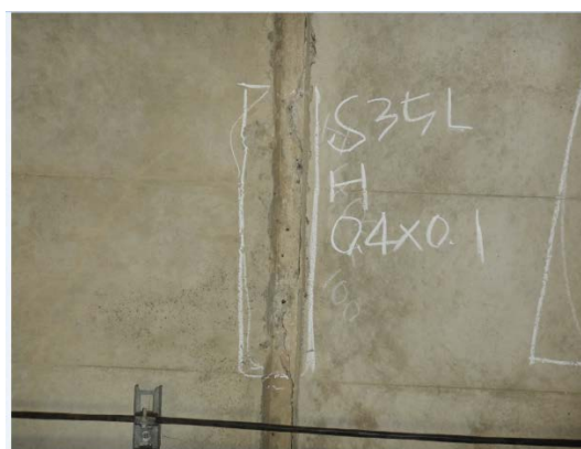
覆工（アーチ）のはく離、はく落
