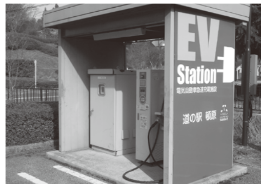
電気自動車急速充電設備(道の駅頓原)
