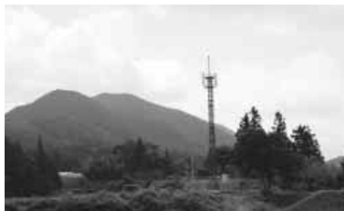
都加賀に設置された通信鉄塔
