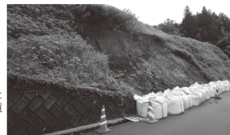
豪雨で被災した 板屋農道
