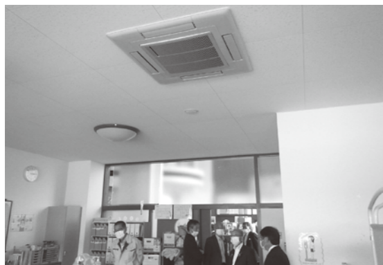
頓原小学校の空調を視察
