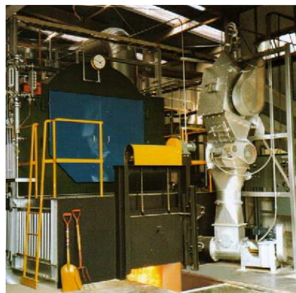
写真11 導入予定の蒸気ボイラー
