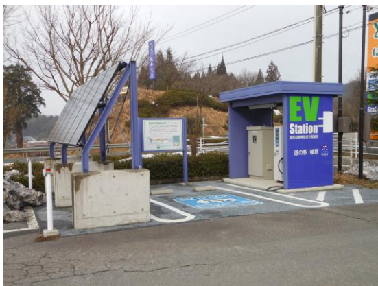
写真6 EVスタンド (道の駅頓原)
