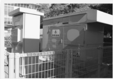
設置された非常用発電機
