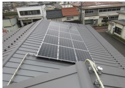
頓原複合施設へ太陽光発電設備設置
