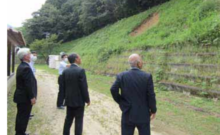
「琴引の里」裏山の法面崩壊現場を確認
