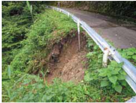
被災した町道
