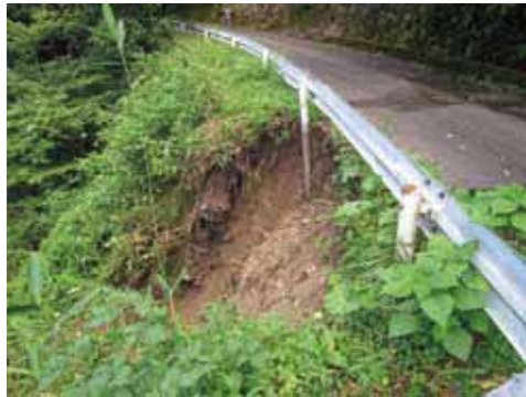
被災した町道
