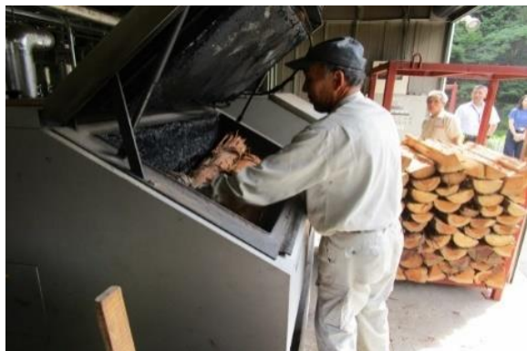
図 23 薪ボイラーへの薪の投入イメージ (岡山県西粟倉村)
