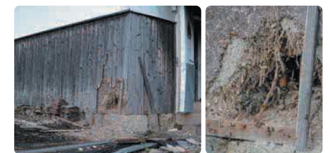
ハチの巣を狙って壊された建物
