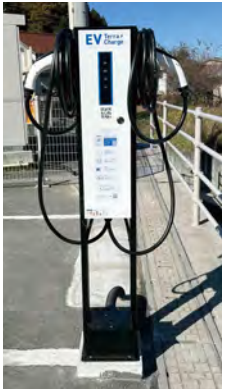
来島交流センターに設置した普通充電器
