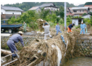
集中豪雨で土砂災害発生
