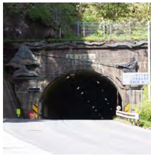
内壁などの劣化が進む 赤名トンネル
