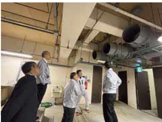
農業集落排水(八神)の換気施設視察
