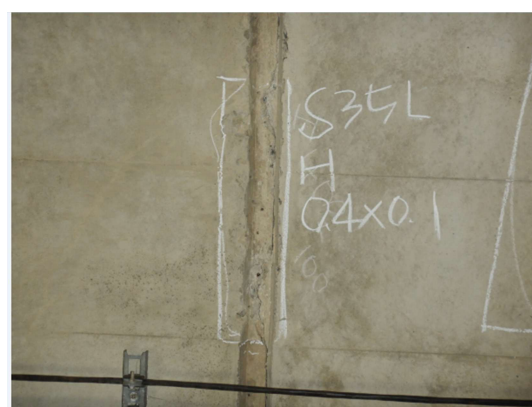
覆工（アーチ）のはく離、はく落
