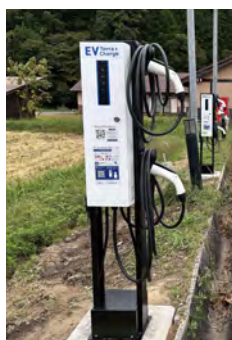
加田の湯には2基4口を設置
