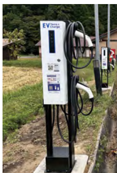
加田の湯には2基4口を設置
